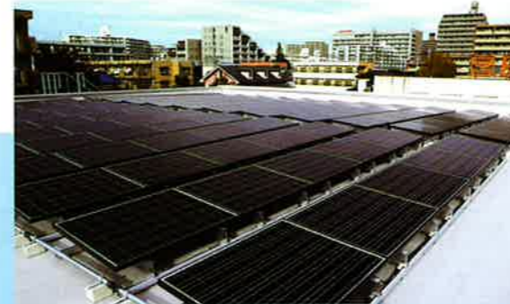
屋上設置の太陽光発電パネル
