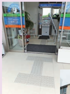
店内誘導点字ブロック
