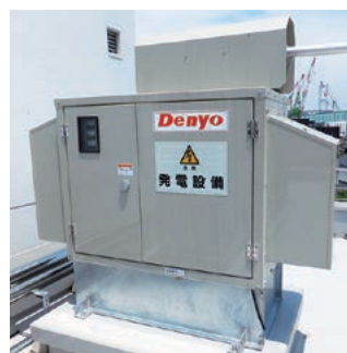
非常用自家発電装置
