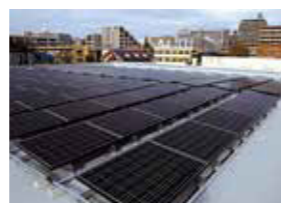
上尾支店の屋上に設置された太陽光発電パネル。ロビーの照明や空調に利用しています
