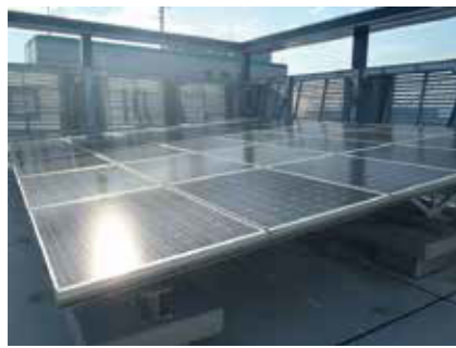
屋上に設置されている太陽光発電パネル。非常用電源としても活用します
