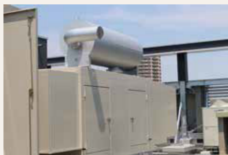
屋上に設置された自家発電装置。非常用電源として活用します
