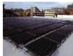
上尾支店の屋上に設置された太陽光発電パネル。ロビーの照明や空調に利用しています
