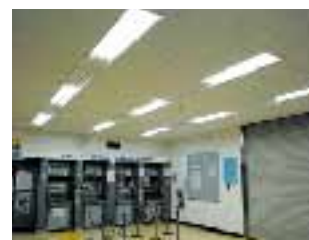
高効率反射板やFHF蛍光灯、LED照明の設置を進めています(本営業部ATMコーナー)
