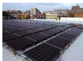
上尾支店の屋上に設置された太陽光発電パネル。ロビーの照明や空調に利用しています
