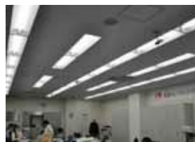
本店や全支店の照明に高効率反射板「レフボ」を設置しました(鳩ヶ谷支店)
