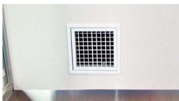
床面換気排気口
