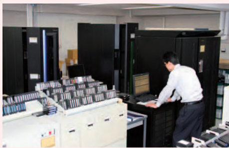
システム部内電算室
