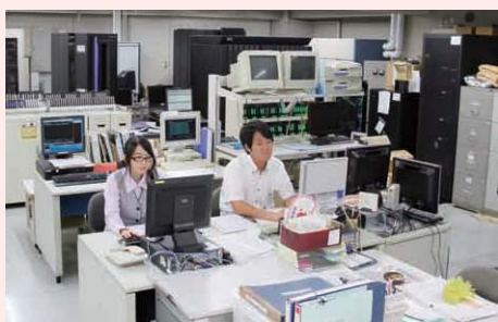
システム部内電算室
