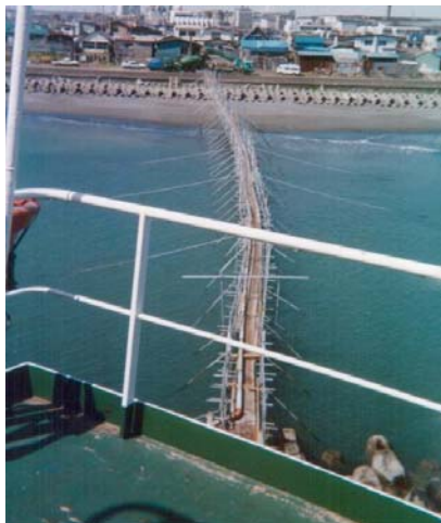
配管状況、左舷前方より ポンプ車に向かい艦橋より 撮影
