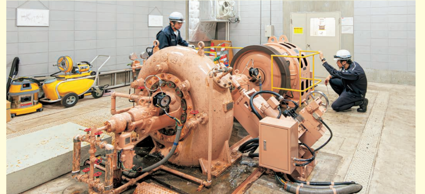
利尻島の電気は島内でつくられ、海岸線に張りめぐらされた配電線により全戸に配電されている。主電力は火力による内燃力発電であるが、大正時代から稼働する2つの小さな水力発電所の灯を、いつでも絶やさないよう技術者たちが故郷の電気を24時間守り続けている。
