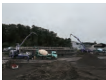
興部町のガス発電プラント
