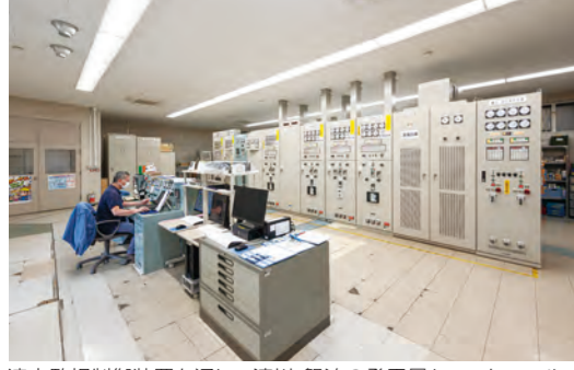
遠方監視制御装置を通して清川・鷺泊の発電量もコントロール。
