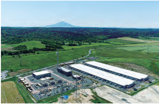
蓄電池設備 (北豊富変電所)
